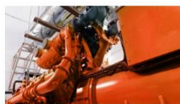
COGENERAZIONE AD ALTO RENDIMENTO
