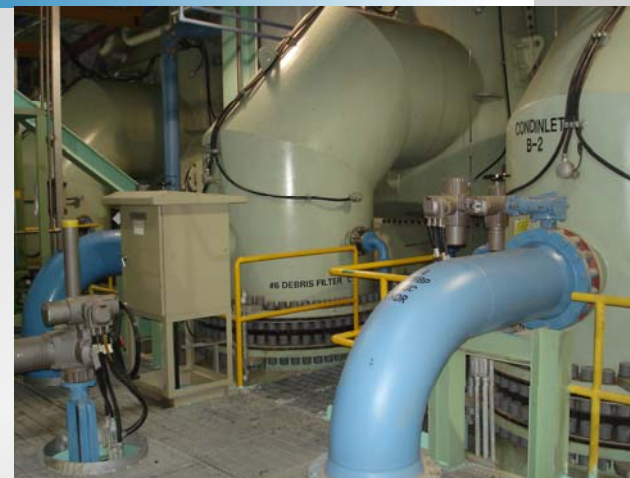
Attuatori elettrici a FO installati in una CTE
