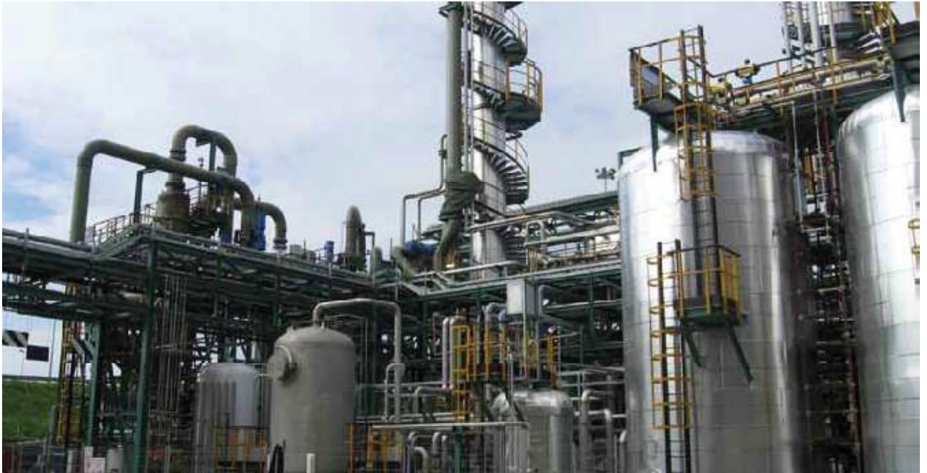
Fig.3 – Impianto pilota di cattura CO 2 presso la Centrale Enel Federico II
